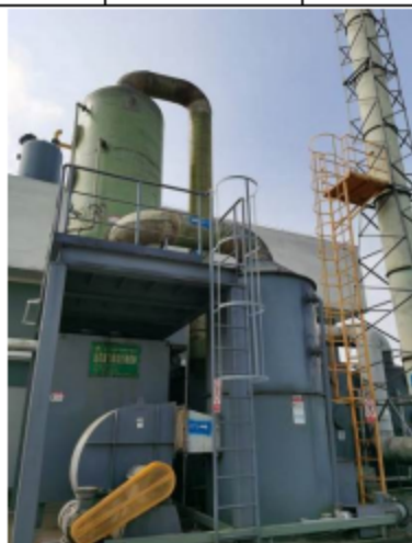
101 车间废气处理设施
