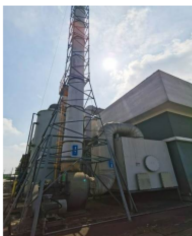
103 车间废气处理设施
