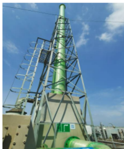
污水处理站废气处理设施
