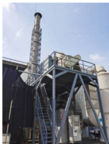
102 车间废气处理设施
