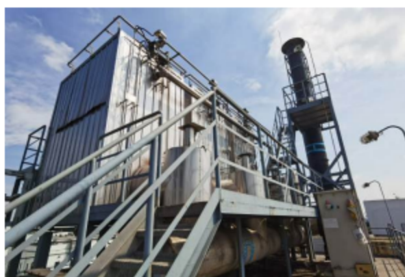
205、206 车间废气处理设施
