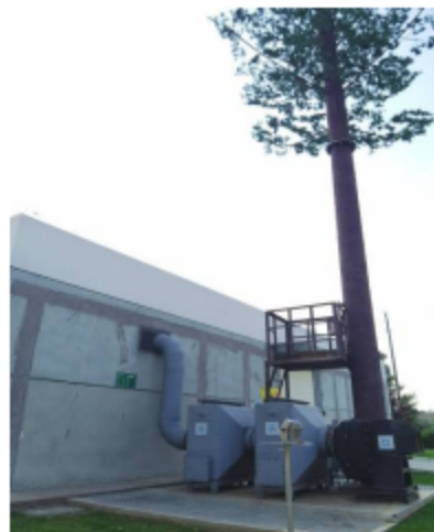
新危废间废气处理设施
